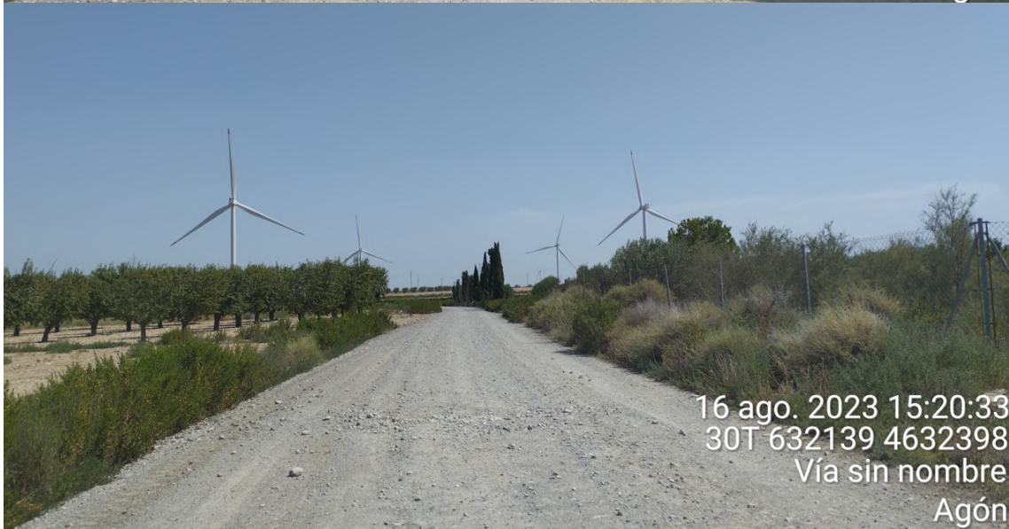
Figura 25: Vial principal de acceso a AG-03. Obsérvese en la segunda fotografía, el tramo de vial a unos 10m al sur de la entrada a AG-02 está deteriorado tanto por la erosión natural como por el tráfico rodado.
