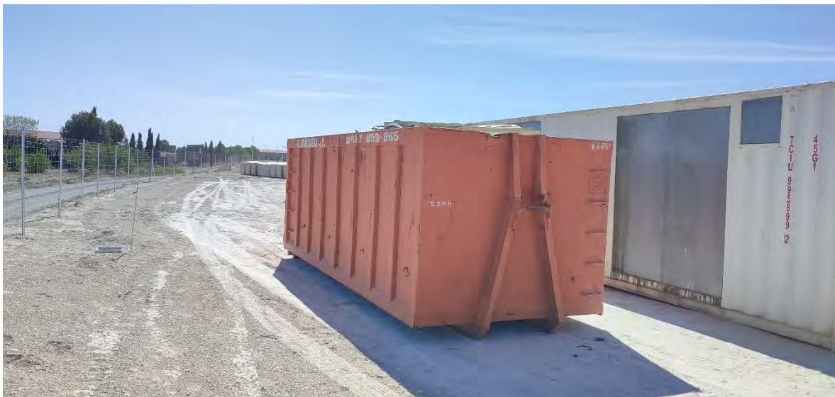
Ilustración 10. Contenedor para la clasificación de los residuos generados en la obra.
