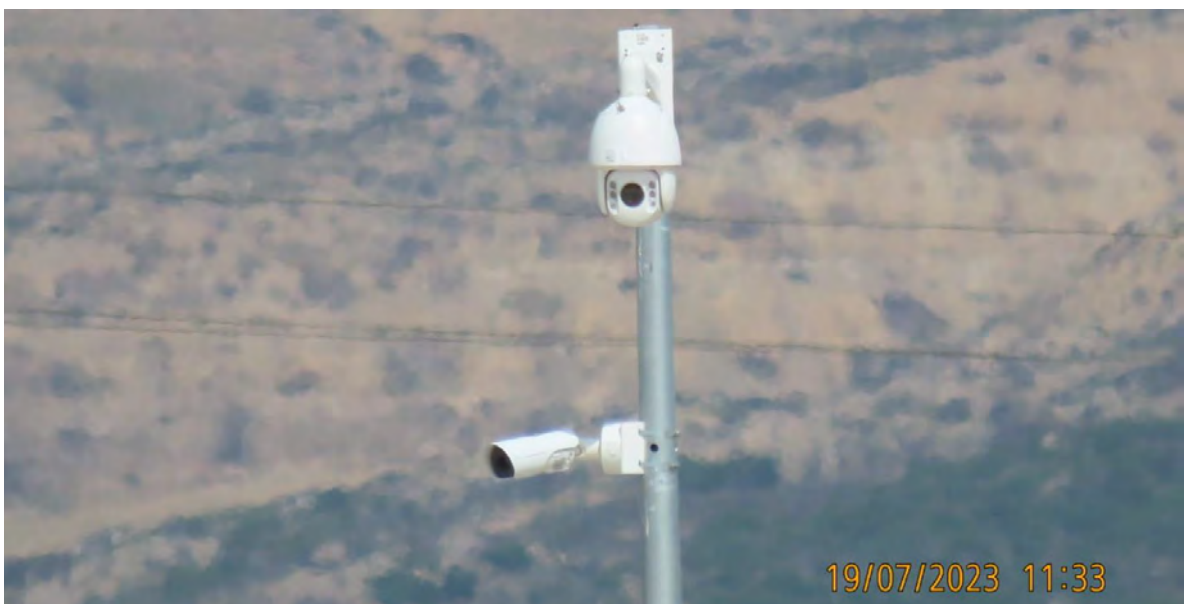
Ilustración 3. Instalación de cámaras de videovigilancia con giro 360°.
