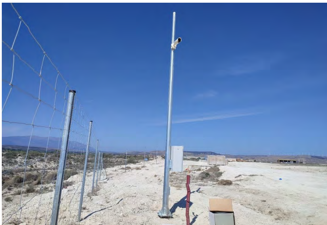
Fotografía 8. Sistema de videovigilancia.
