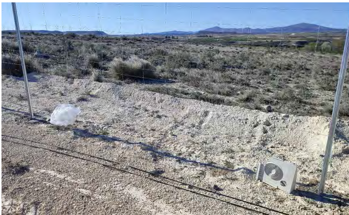
Fotografía 10. Residuos plásticos acumulados en el vallado perimetral.
