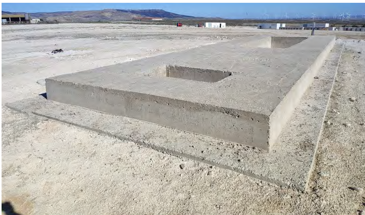
Fotografía 4. Base cimentada del Centro de transformación.
