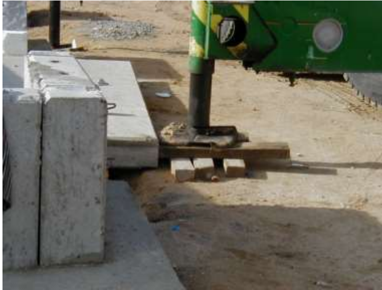
Buen apoyo de la grúa en el suelo. Uso de tablones de madera
