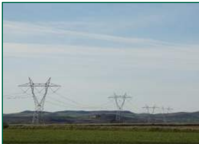
Fotografía 7. Línea eléctrica de Alta Tensión 400kV ARAGÓN- MORELLA al sur de la planta fotovoltaica.
