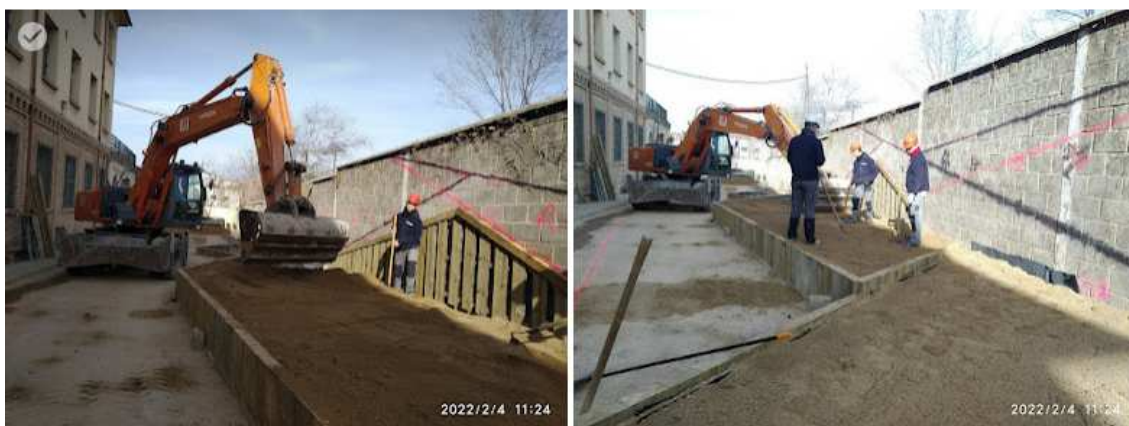
VERTIDOS DE TIERRA, PREVIAMENTE SE HIZO UNA ENMIEDA EN LA TIERRA VEGETAL MUY ARCILLOSA CON ARENA LAVADA
