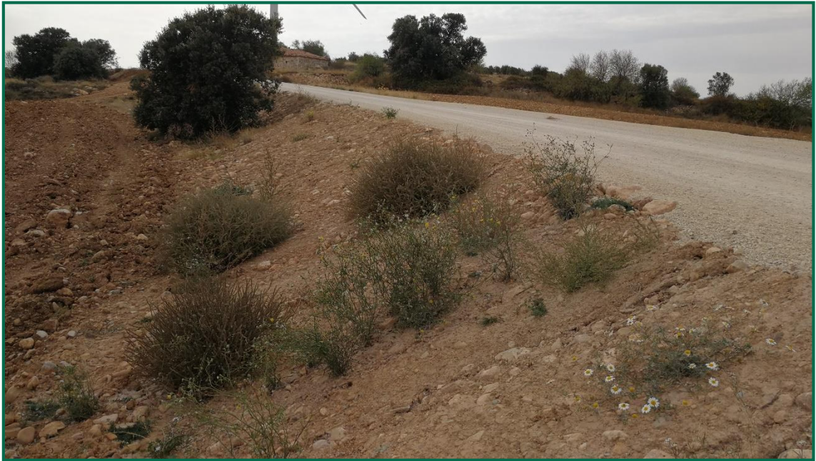
Fotografía 4. Taludes pendientes de revegetación. (Pista acceso a A1.3)
