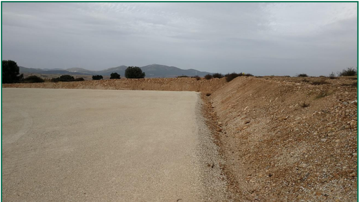
Fotografía 5. Taludes pendiente de revegetación (plataforma de A1.4)
