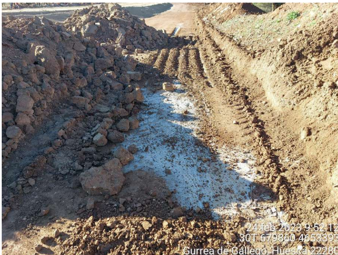
Imagen 1. Residuo de hormigón en el pozo de lavado que se restauró y limpió incorrectamente. Cuando se limpie y se gestione correctamente se cerrará la NC.
