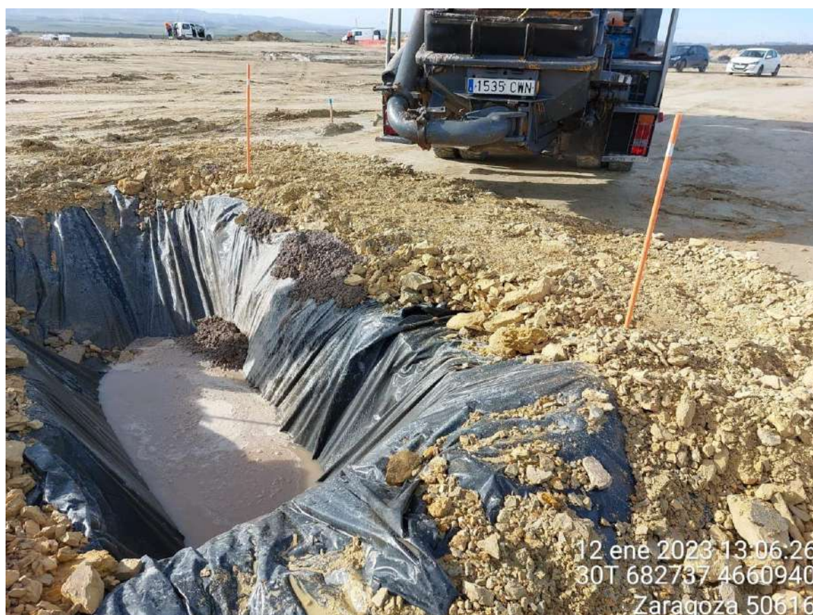
Imagen 2. Pozo de lavado en buen estado apto para el lavado de hormigón en OBIII.
