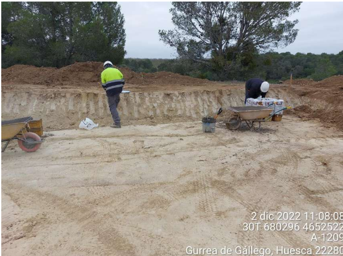
Imagen 2. Residuo de hormigón en el suelo. Se debe poner plástico para proteger el suelo y trabajar sobre él.
