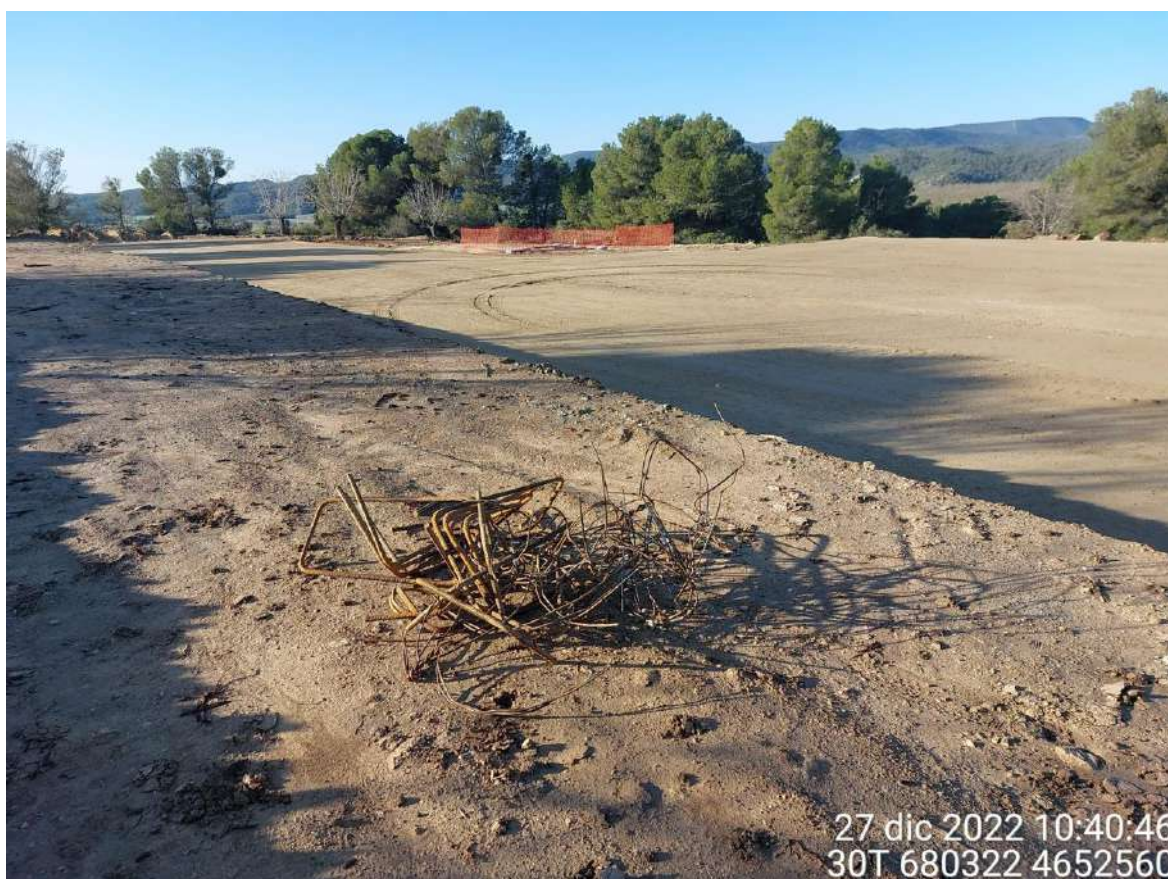
Imagen 1. Restos de ferralla en la zona de la TM en OBII. Se debe retirar cuanto antes.
