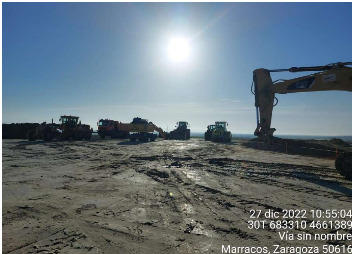
Imagen 2. Maquinaria parada en OBIII-01 y sin cubetos de contención que actúen y protejan el suelo ante posibles fugas.
