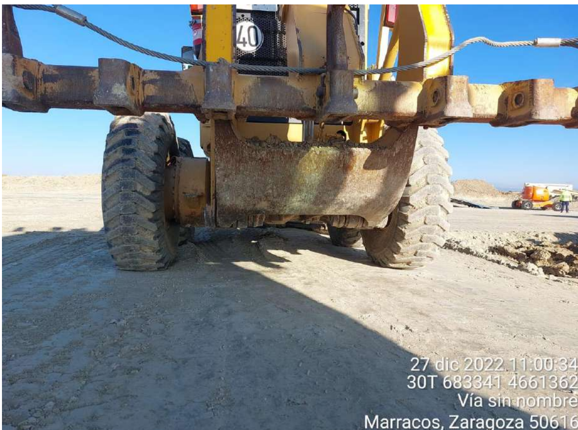
Imagen 3. Maquinaria parada en OBIII-01 y sin cubetos de contención que actúen y protejan el suelo ante posibles fugas.
