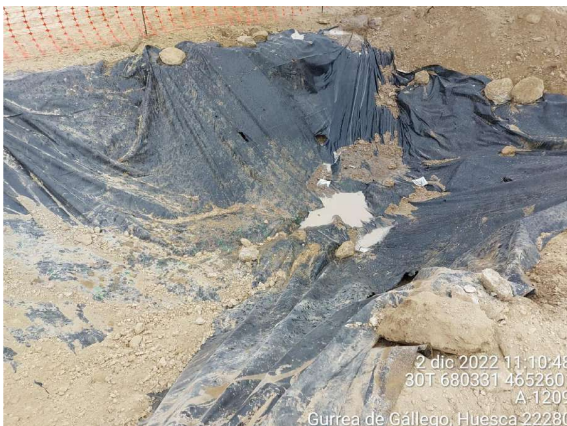
Imagen 1. No conformidad leve. Pozo de lavado en mal estado que genera contaminación del suelo por residuo de hormigón.
