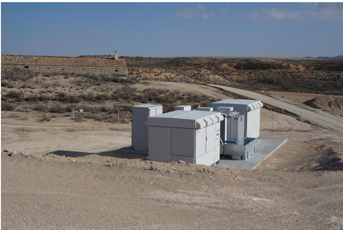
Figura 8 Estación de transformación eléctrica
