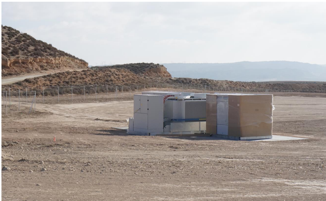
Figura 2b Estación de transformación eléctrica
