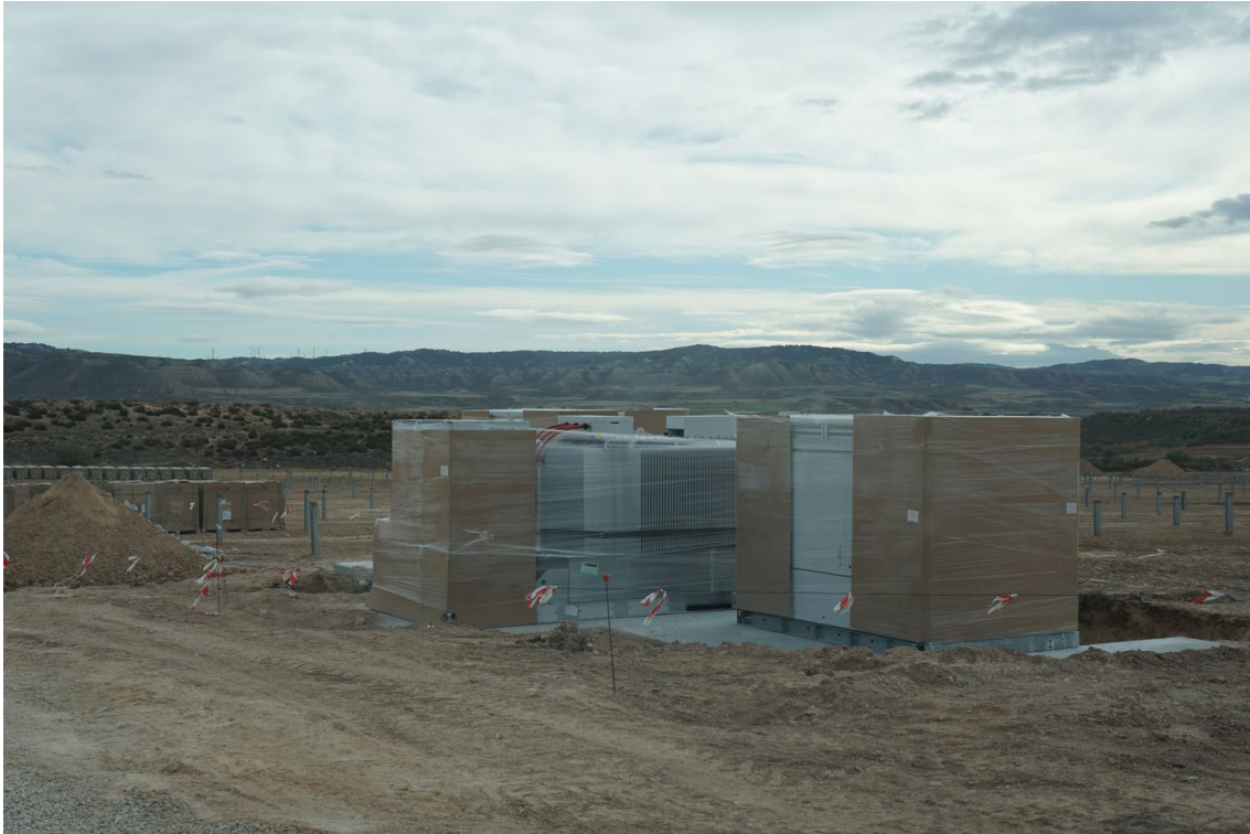
Figura 6 Estación de transformación eléctrica
