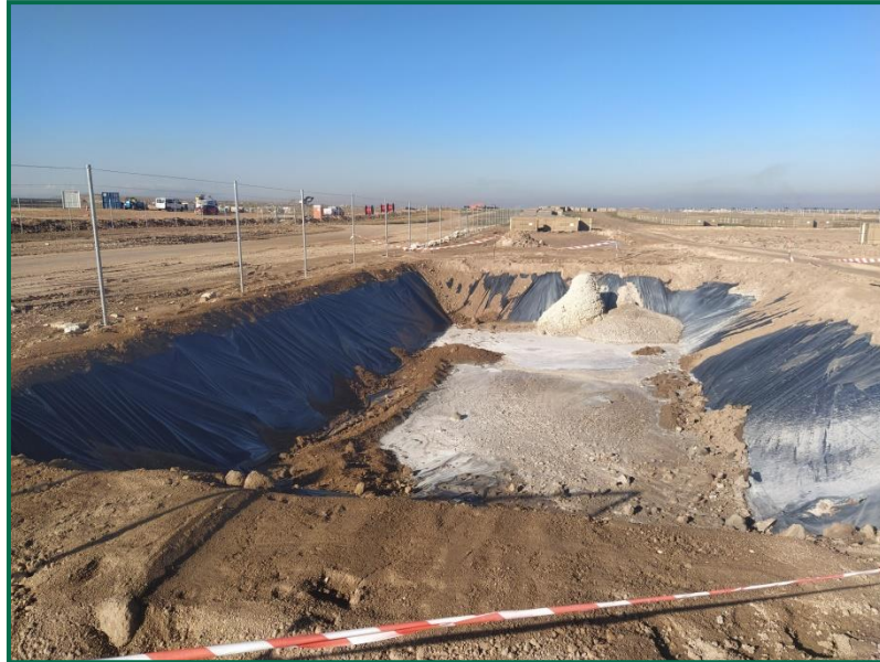
Fotografía 6. Zona de lavado de hormigón.
