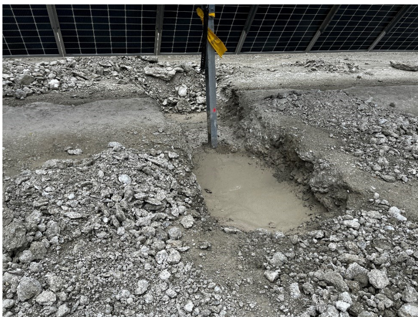
Figura 2 Cimentaciones de las hincas rechazadas
