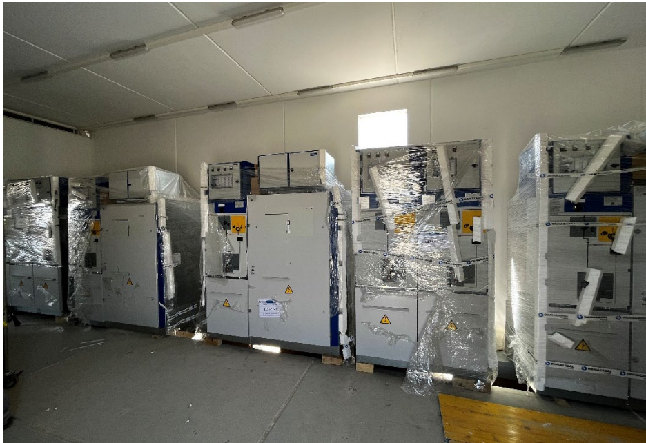
Figura 38 Armarios de control SET Cartujos
