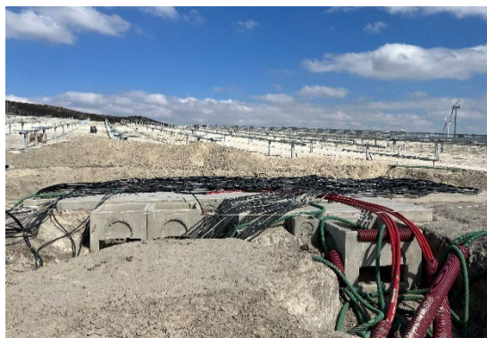
Figura 12 Cableado de los centros de transformación
