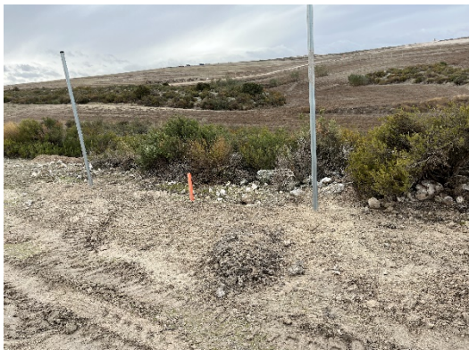
Figura 21 Pequeños vertidos de hormigón
