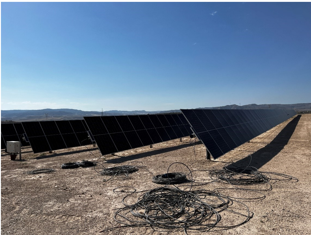
Figura 9 Cableado de la baja tensión
