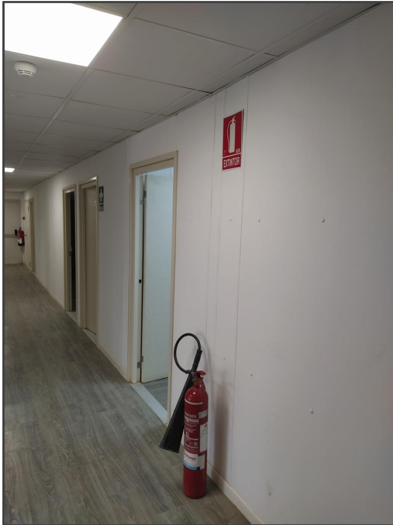
Fotografía 14. Extintores en edificio de control.
