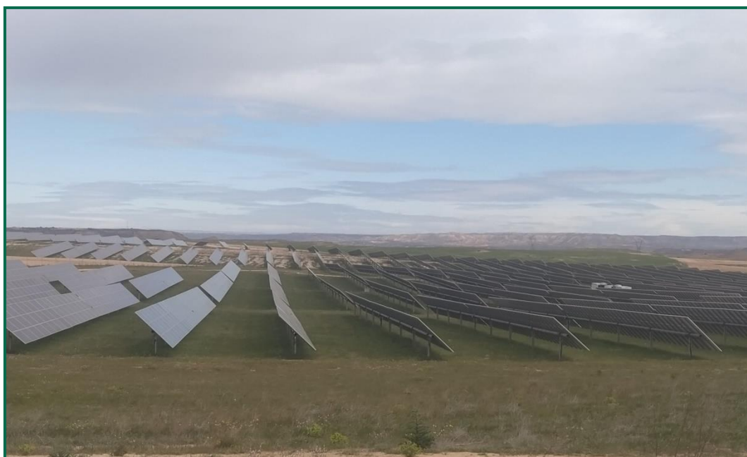
Fotografía 1. Vegetación entre placas en su estado actual.
