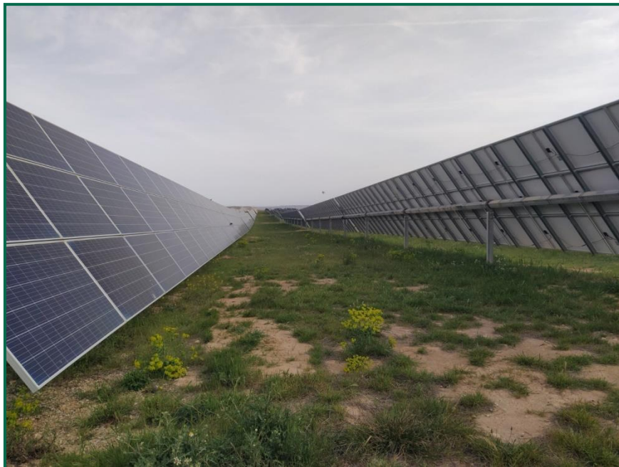
Fotografía 1. Vegetación entre placas en su estado actual.
