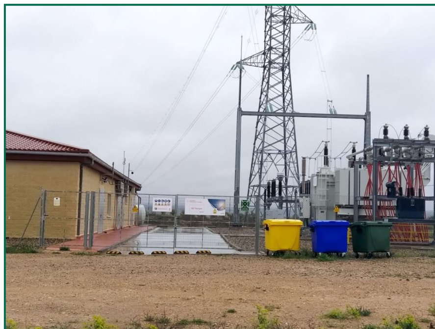
Fotografía 6. Contenedores para residuos en la SET.
