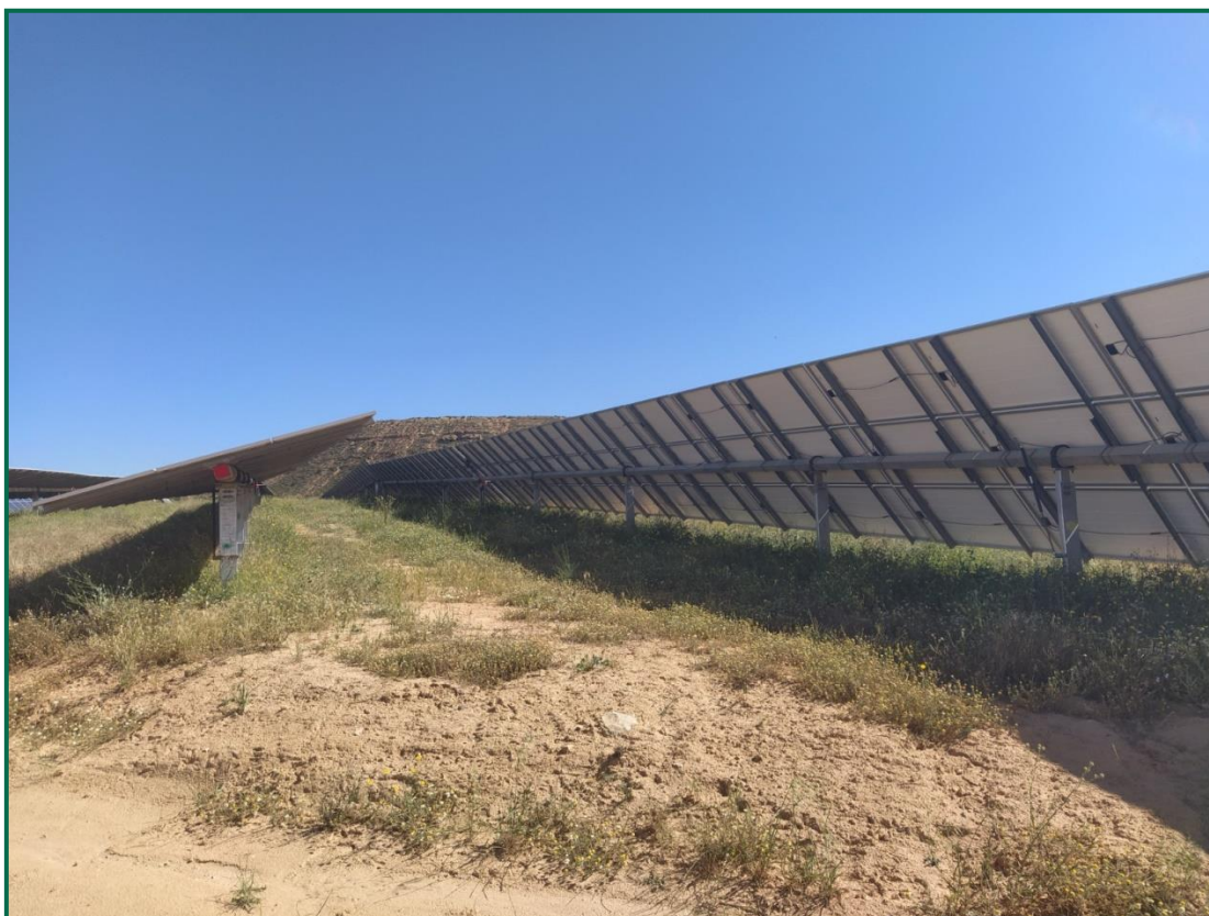
Fotografía 1. Vegetación entre placas actualmente.
