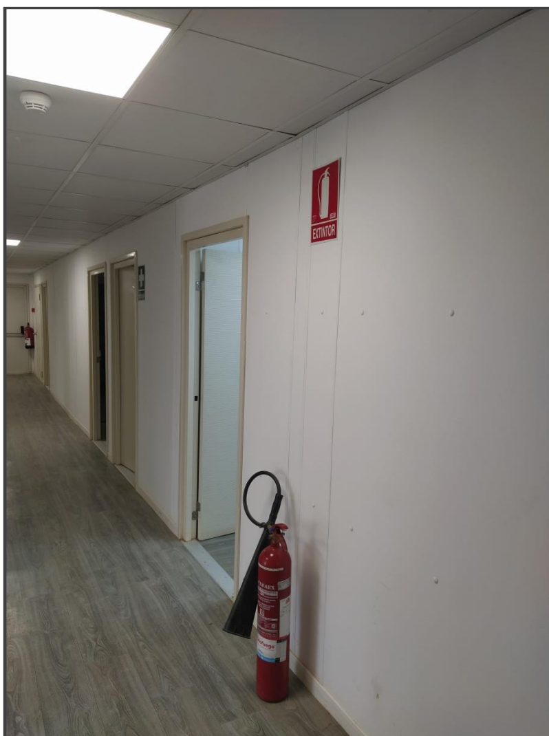
Fotografía 11. Extintores en edificio de control.
