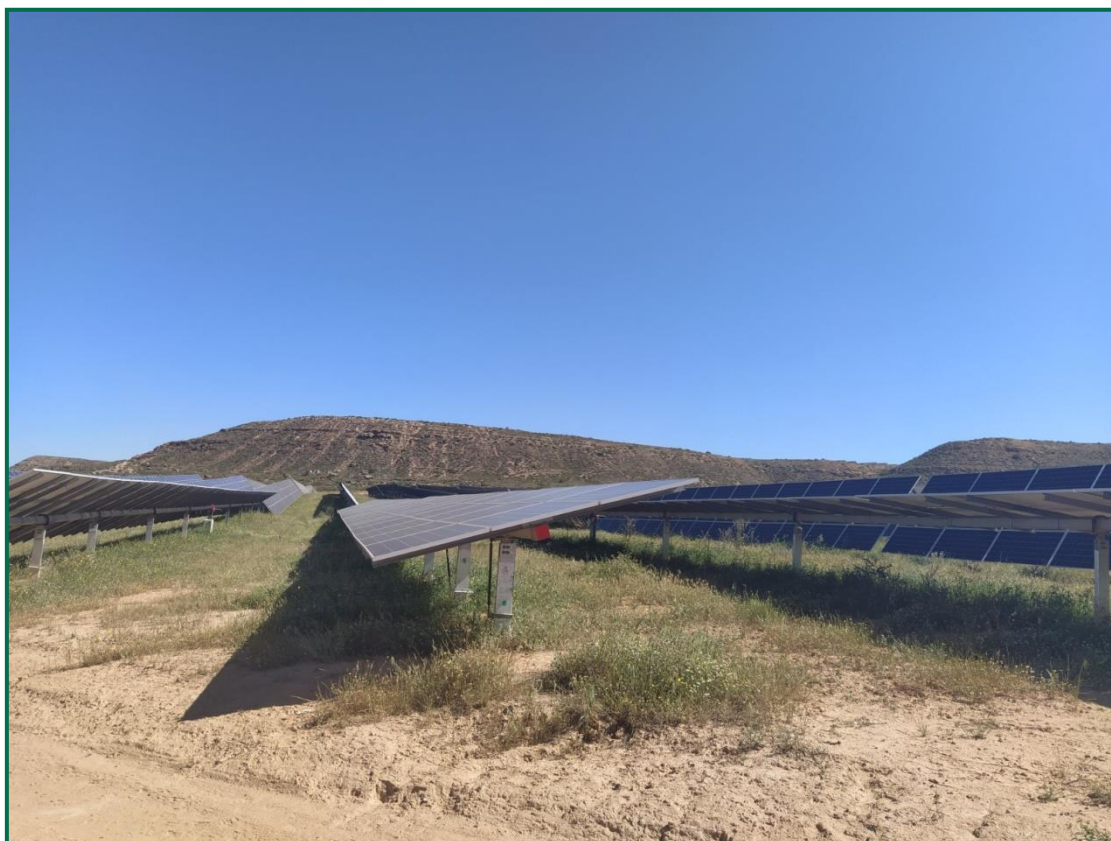
Fotografía 1. Vegetación entre placas actualmente.
