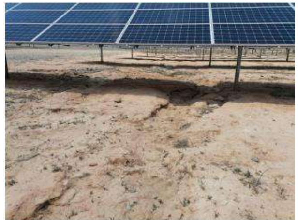
Fotografía 112. -Procesos erosivos Cárcavas y arrastres bajo seguidores y caminos de servicios. Mayo 2023.
