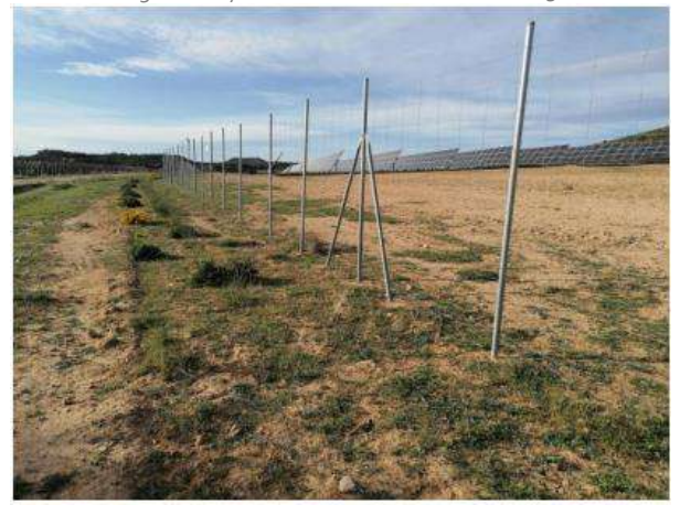
Fotografía 46.- Estado de la pantalla perimetral en torno a la pista central (semi-recinto Oeste). Marzo 2023.
