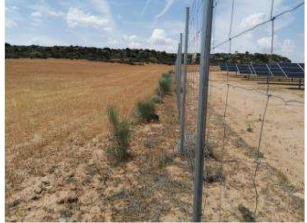
Fotografía 116. -Estado de la pantalla perimetral, lado Sur (semi-recinto Oeste). Mayo 2023.
