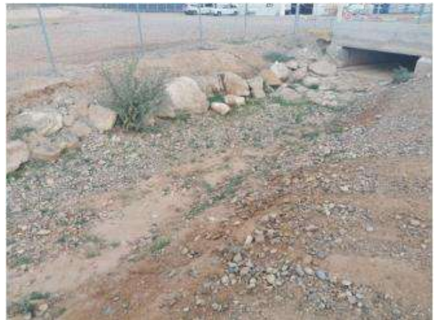
Fotografía 102. -Procesos erosivos. Cuneta reparada bajo puente de acceso a PSFV. Mayo 2023.
