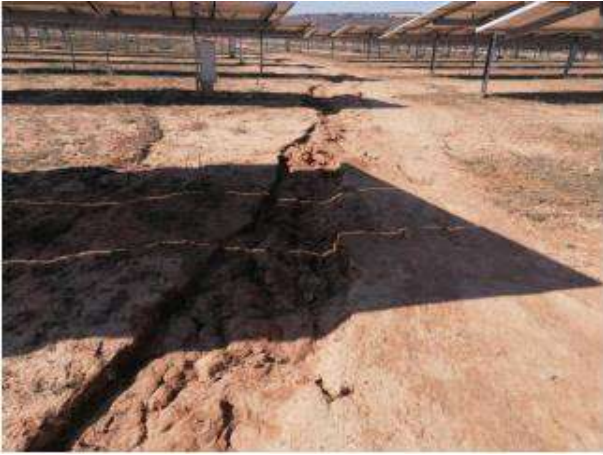
Fotografía 13.- Procesos erosivos. Cárcavas y arrastres bajo seguidores. Febrero 2023.
