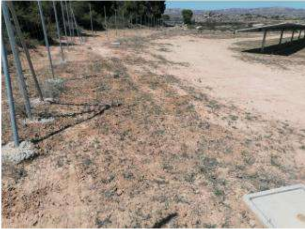
Fotografía 73.- Permeabilidad del vallado. Hozaduras de jabalí dentro del perímetro vallado. Abril 2023.
