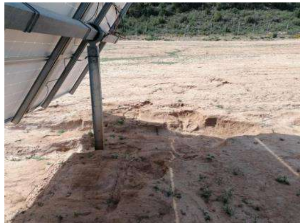
Fotografía 40.- Procesos erosivos. Cárcavas y arrastres bajo seguidores y caminos de servicio. Marzo 2023.
