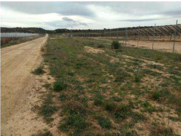
Fotografía 59. -Procesos erosivos. Cuneta colmada por arrastre de limos y arcillas. Marzo 2023.
