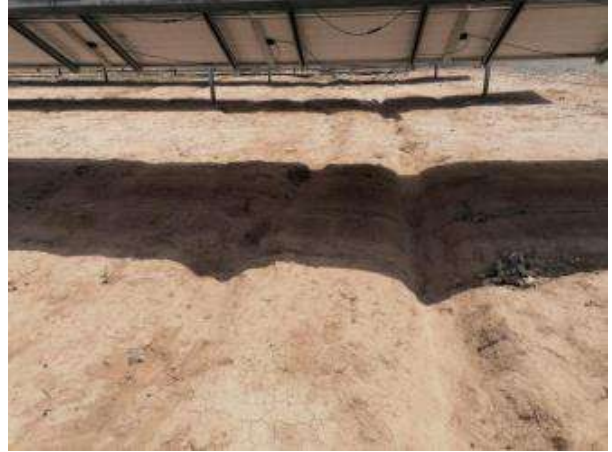
Fotografía 104. -Procesos erosivos Cárcavas y arrastres bajo seguidores y caminos de servicio. Mayo 2023.
