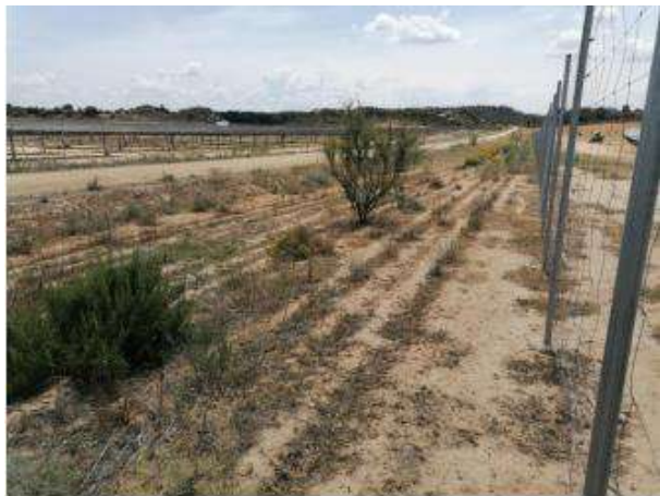
Fotografía 117. -Estado de la pantalla perimetral en torno a la pista central (semi-recinto Oeste). Mayo 2023.
