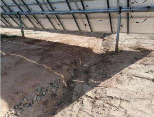
Fotografía 43.- Procesos erosivos. Cárcavas y arrastres bajo seguidores y caminos de servicio. Marzo 2023.
