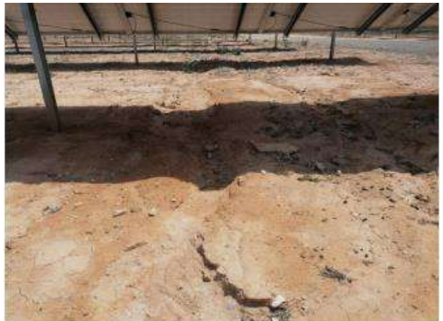
Fotografía 106. -Procesos erosivos Cárcavas y arrastres bajo seguidores y caminos de servicio. Mayo 2023.
