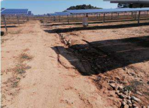
Fotografía 12.- Procesos erosivos. Cárcavas y arrastres bajo seguidores. Febrero 2023.
