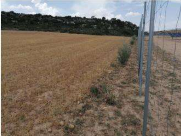
Fotografía 115. -Estado de la pantalla perimetral, lado Sur (semi-recinto Oeste). Mayo 2023.
