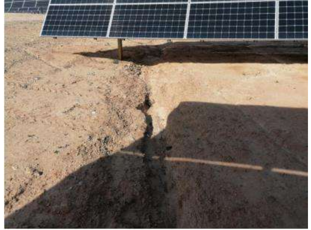
Fotografía 44.- Procesos erosivos. Cárcavas y arrastres bajo seguidores y caminos de servicio. Marzo 2023.
