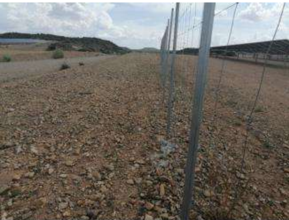
Fotografía 113. -Estado de la pantalla perimetral, lado Norte (semi-recinto Oeste). Mayo 2023.
