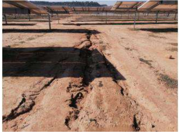
Fotografía 14.- Procesos erosivos. Cárcavas y arrastres bajo seguidores. Febrero 2023.
