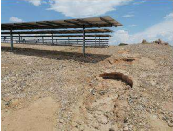
Fotografía 103. -Procesos erosivos Cárcavas y arrastres bajo seguidores y caminos de servicio. Mayo 2023.
