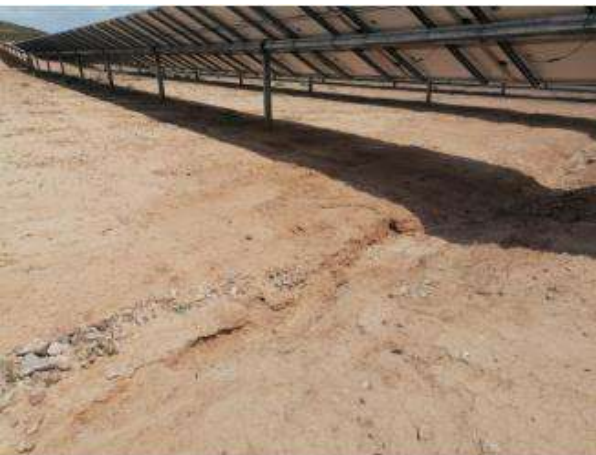
Fotografía 111. -Procesos erosivos. Cárcavas y arrastres bajo seguidores y caminos de servicios. Mayo 2023.
