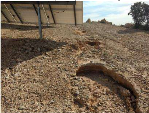
Fotografía 39.- Procesos erosivos. Cárcavas y arrastres bajo seguidores y caminos de servicio. Marzo 2023.
