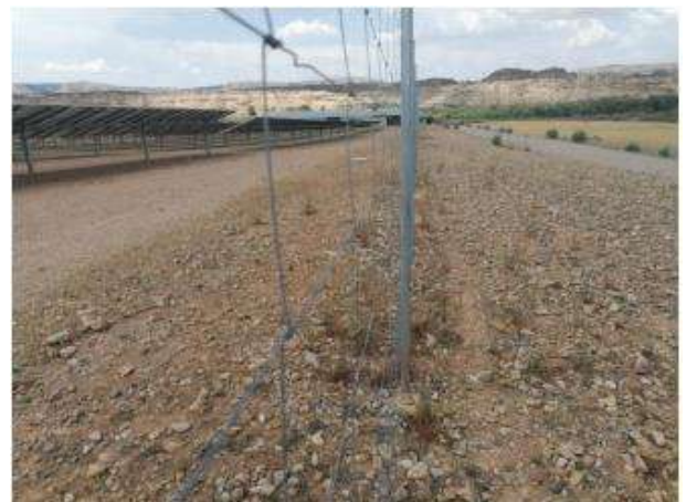
Fotografía 114. -Estado de la pantalla perimetral, lado Norte (semi-recinto Oeste). Mayo 2023.
