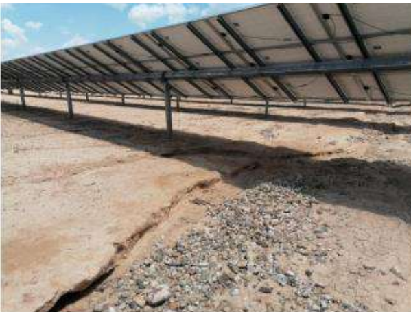
Fotografía 105. -Procesos erosivos Cárcavas y arrastres bajo seguidores y caminos de servicio. Mayo 2023.
