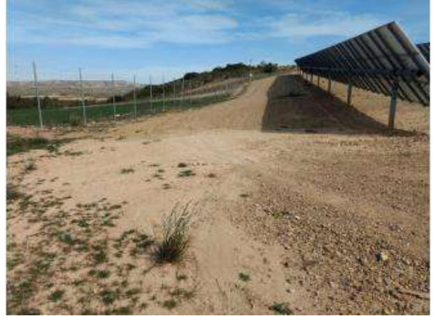
Fotografía 110. -Procesos erosivos. Arrastre de limos y arcillas en camino. Mayo 2023.
