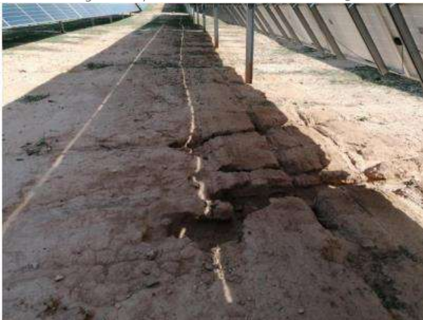
Fotografía 41.- Procesos erosivos. Cárcavas y arrastres bajo seguidores y caminos de servicio. Marzo 2023.
