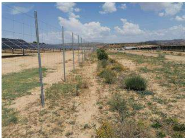
Fotografía 119. -Estado de la pantalla perimetral en torno a la pista central (semi-recinto Oeste). Mayo 2023.
