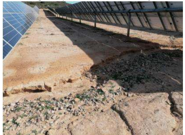
Fotografía 42.- Procesos erosivos. Cárcavas y arrastres bajo seguidores y caminos de servicio. Marzo 2023.
