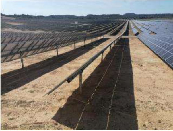
Fotografía 61.- Estado del suelo en bloques de construcción reciente. Cubierta vegetal rala y escasa. Abril 2023.
