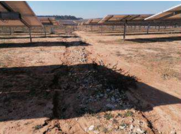
Fotografía 11.- Procesos erosivos. Cárcavas y arrastres bajo seguidores. Febrero 2023.
