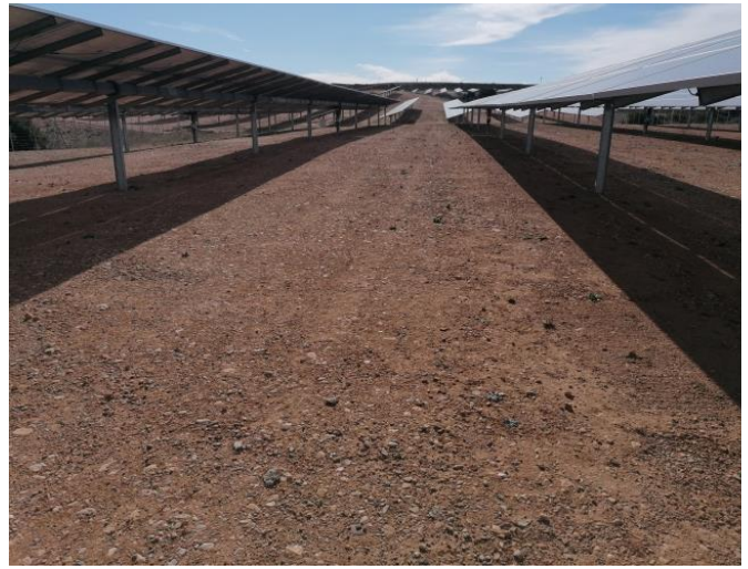
Fotografía 02.- Estado del suelo en bloques de construcción reciente. Cubierta vegetal rala y escasa. Enero 2023
