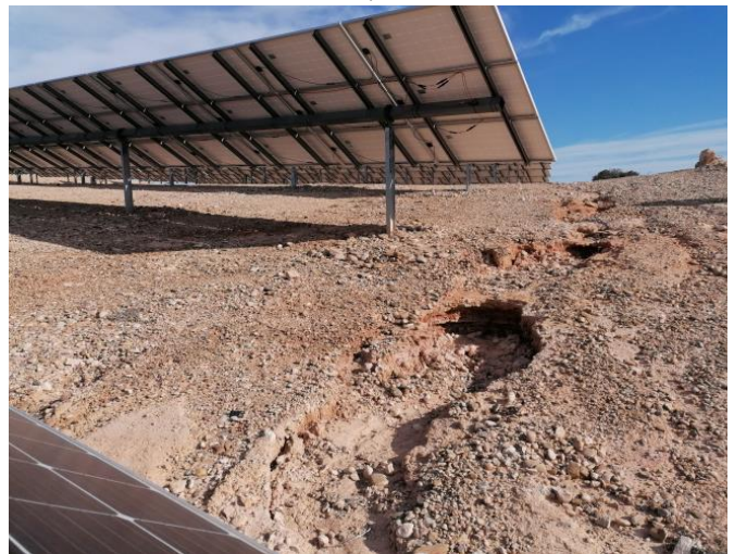
Fotografía 28.- Procesos erosivos. Cárcavas y arrastres bajo seguidores. Enero 2023
