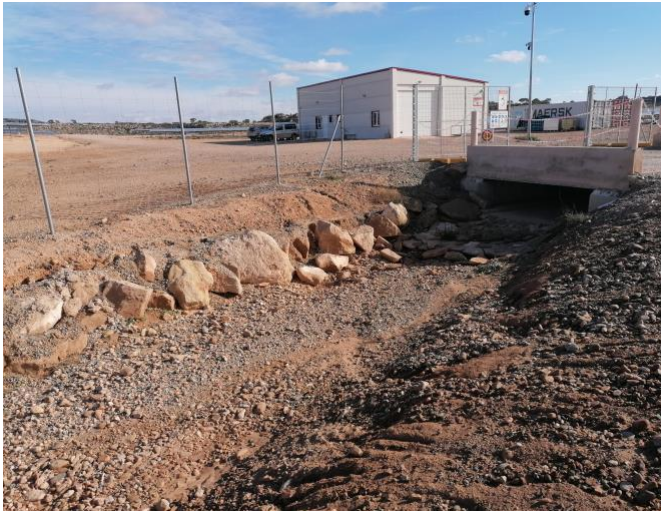
Fotografía 31.- Procesos erosivos junto al puente de acceso a la PSFV que amenazan la base del vallado. Aporte de piedras para construir escollera de defensa frente a avenidas. Noviembre 2023
