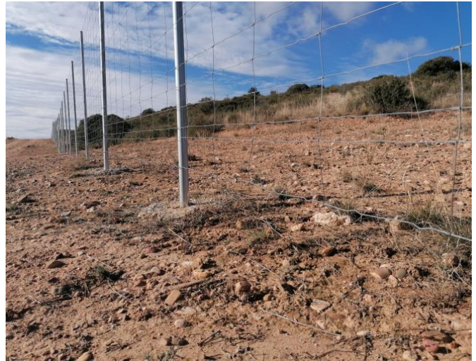
Fotografía 44.- Permeabilidad del vallado: Espacio bajo el vallado. Noviembre 2022
