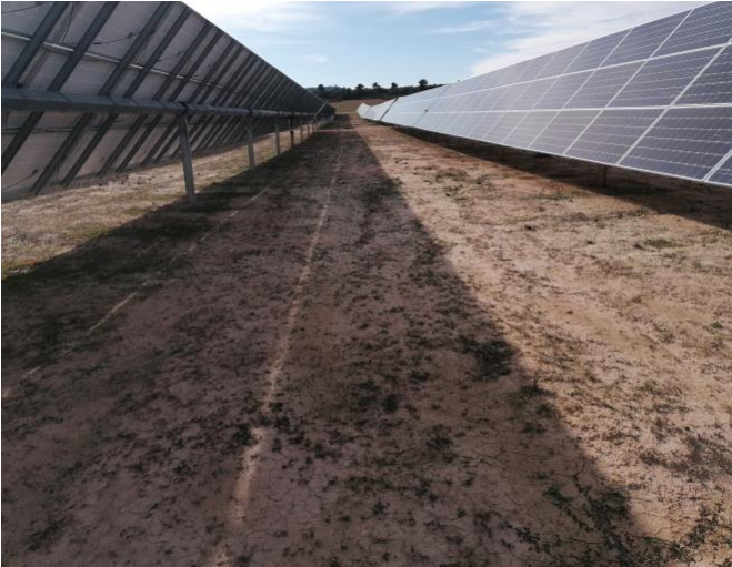
Fotografía 07.- Estado del suelo en bloques de construcción reciente. Cubierta vegetal rala y escasa. Enero 2023
