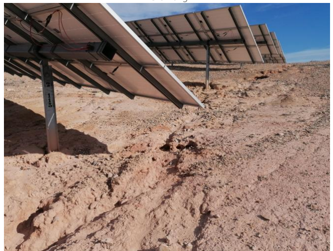
Fotografía 30.- Procesos erosivos. Cárcavas y arrastres bajo seguidores. Enero 2023
