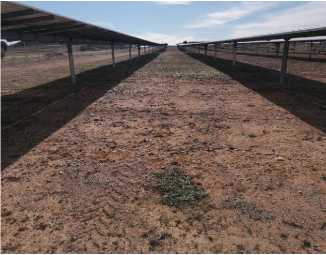
Fotografía 01.- Estado del suelo en bloques de construcción reciente. Cubierta vegetal rala y escasa. Enero 2023
