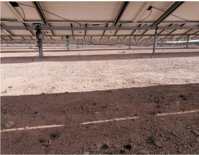
Fotografía 03.- Estado del suelo en bloques de construcción reciente. Cubierta vegetal rala y escasa. Enero 2023
