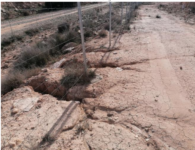
Fotografía 29.- Procesos erosivos. Cárcavas y arrastres bajo seguidores. Enero 2023
