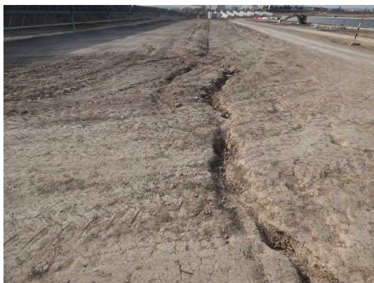
Figura 11. Proceso erosivo localizado en el interior de la planta fotovoltaica
