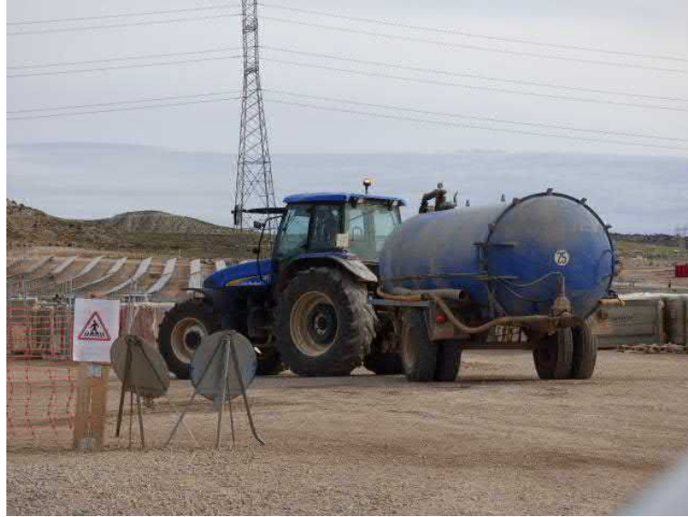
Figura 1. Cuba de riego presente en la obra y utilizada para el riego de los caminos interiores de la planta fotovoltaica
