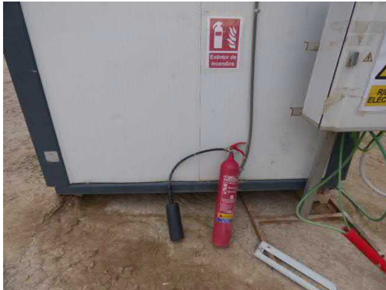
Figura 17. Extintor junto a una de las casetas de obra
