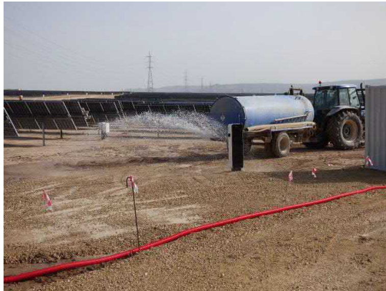
Figura 2. Cuba aplicando riego en uno de los caminos interiores de la planta fotovoltaica
