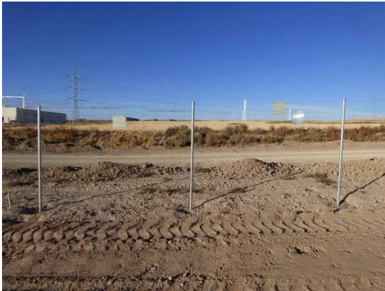
Figura 30. Vallado perimetral de la planta fotovoltaica
