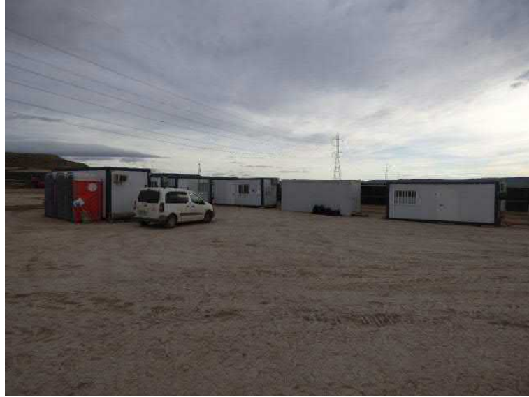
Figura 13. La zona de instalaciones auxiliares situada actualmente en el interior de la planta fotovoltaica
