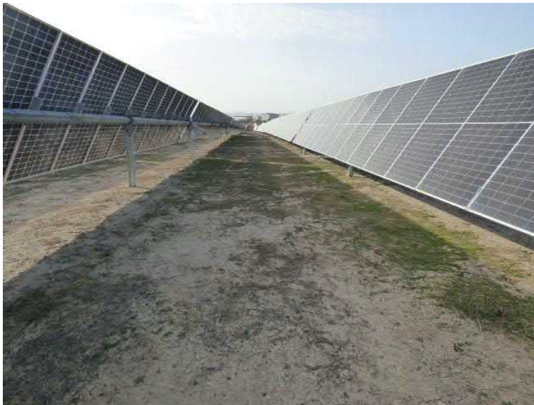
Figura 21. Vegetación natural que de manera espontánea coloniza algunas de las calles entre paneles solares
