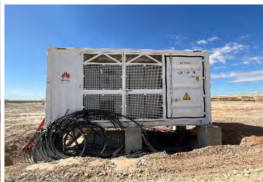
Figura 12 Cableado de los centros de transformación
