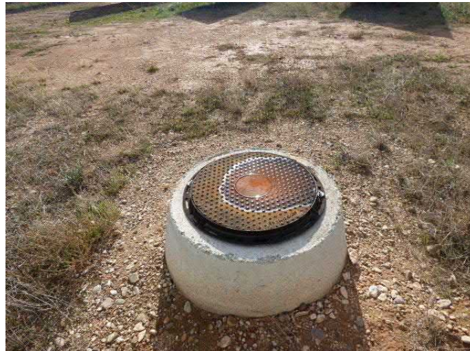
Imágenes 1, 2 y 3 : Depósito de agua limpia, vista externa e interna (imágenes superiores). Depósito estanco (foto exterior)
