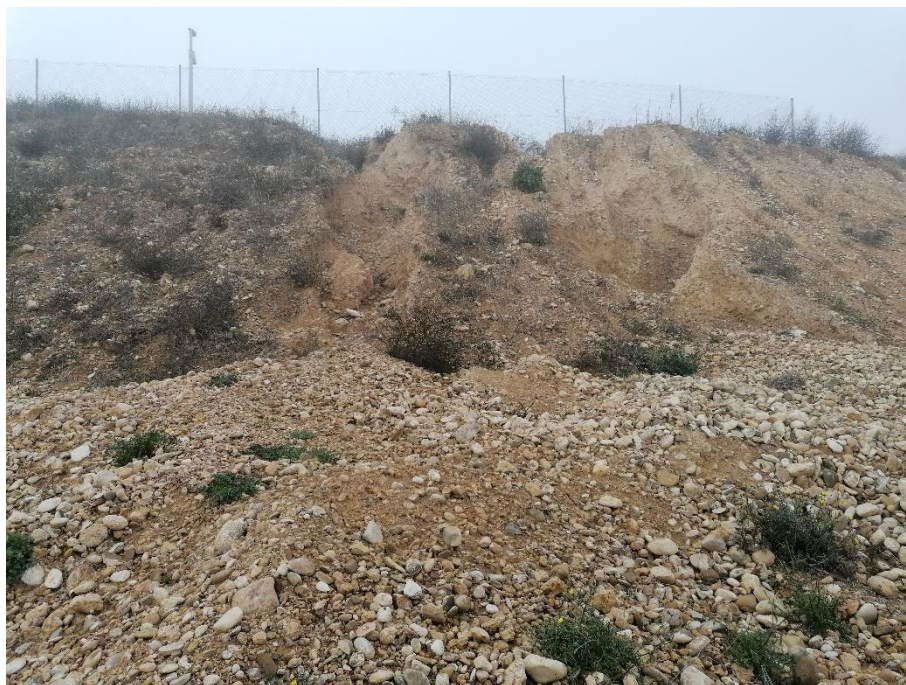
Imagen 1: Estado en el que se encontraba el talud exterior situado en el extremo Noreste de la planta fotovoltaica, antes de iniciar los trabajos de restauración
