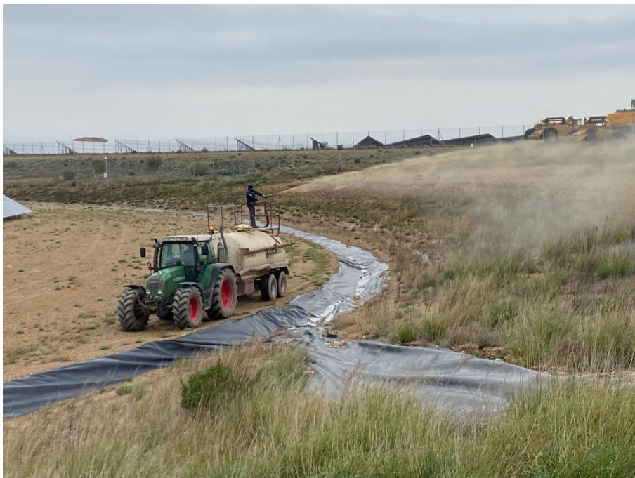
Imagen 4: Talud interior de la planta fotovoltaica cuyo resultado de restauración no ha sido el esperado, por lo que se ha aplicado hidrosiembra sobre el mismo
