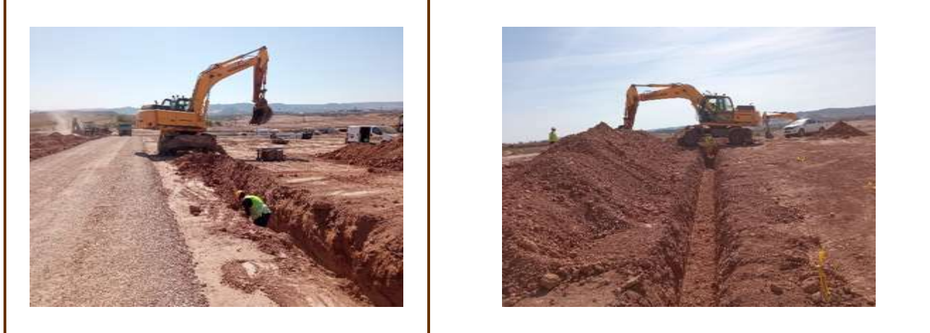
Fot. 3 y 4 Realización del zanjeado de BT en Zonas 8 y 9 de PSFV Pitarco A Oeste
