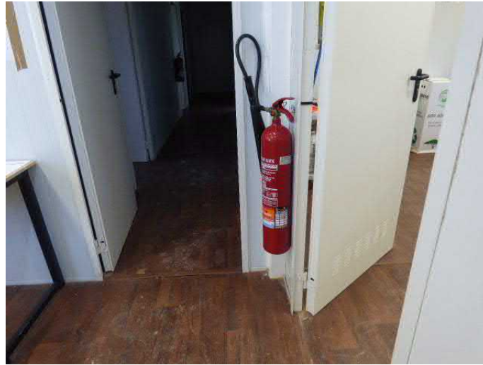
Imagen 30: Foto del extintor disponible en uno de los edificios de O&M.
