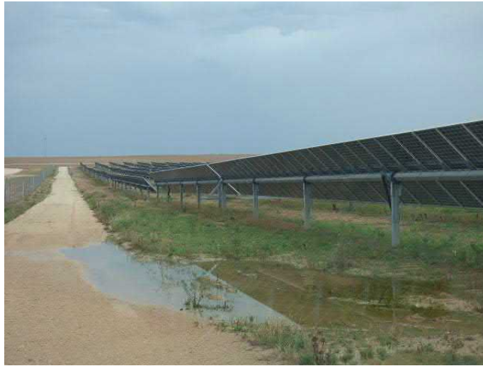
Imagen 3 : Inundación en la zona este del parque "Escucha II".
