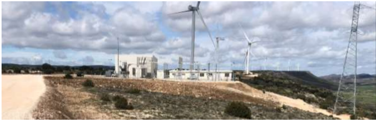
Figura 2: Vistas de la subestación
