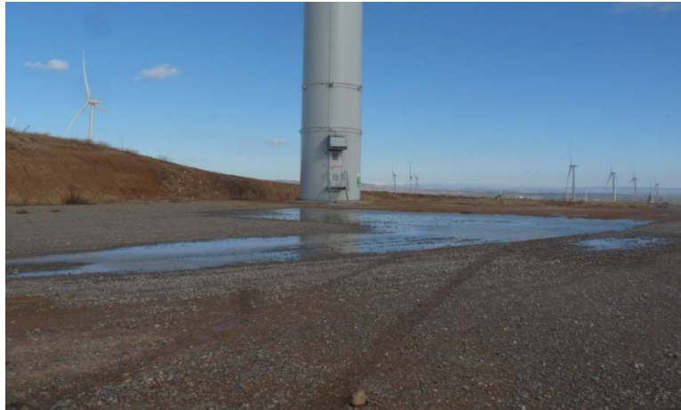
Foto 7. Plataforma del aerogenerador SFB-02 tras el periodo de lluvias
