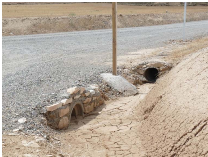
Foto 8. Drenaje en vial y paso en acceso a finca
