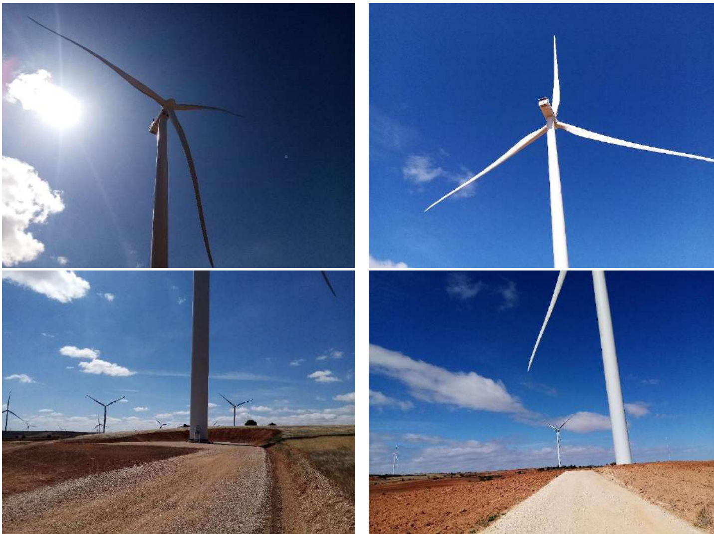
Fotografías 5 a 8: Barquillas de los aerogeneradores y estado de los caminos y viales
