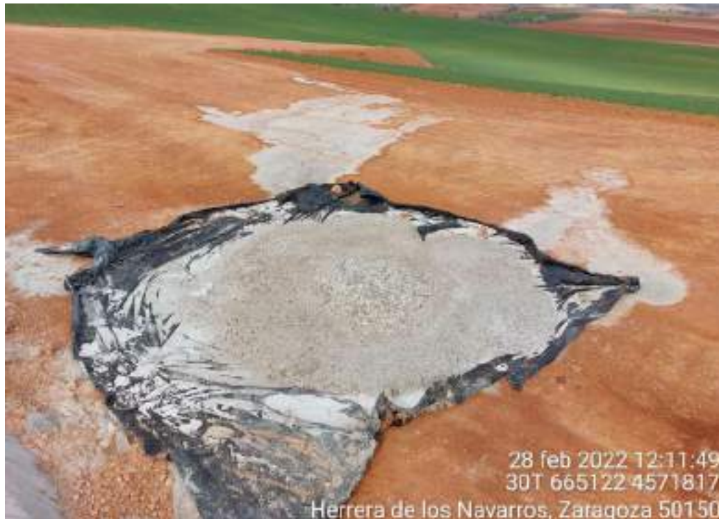
Imagen 4. Residuo de hormigón en SBII-05
