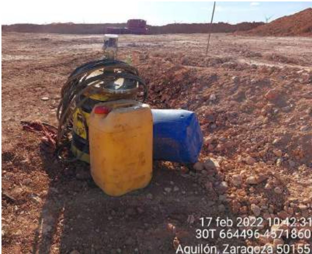
Imagen 3. Bidones de hidráulico y manguera sin protección al suelo en SBII-03
