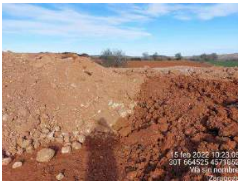
Imagen 2. Posible contaminación de la tierra vegetal. Recomiendo de nuevo balizar los cordones de tierra vegetal para lograr una separación segura y eficiente.
