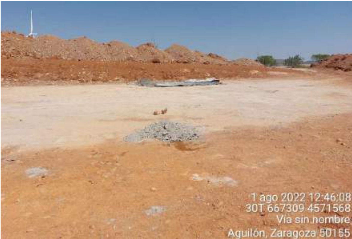
Imagen 2. Residuo de hormigón en el suelo de la plataforma PLX-1.
