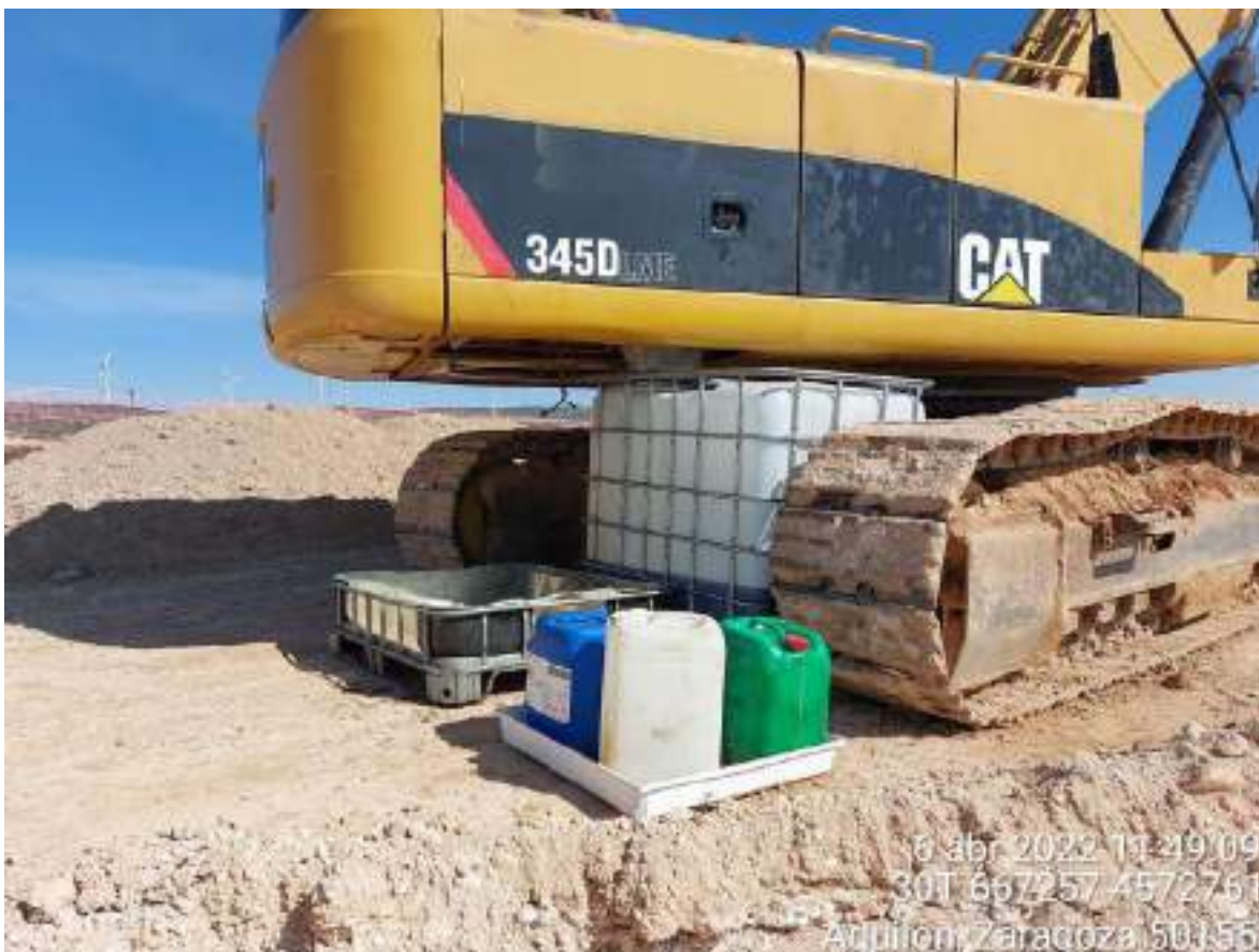
Imagen 5. Bidones colocados sobre cubetos de contención.
