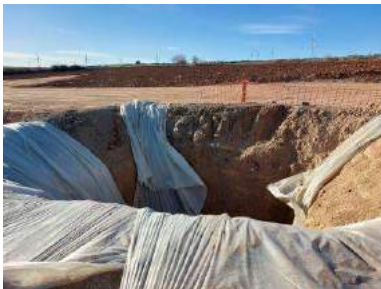
Imagen 1. La zona de lavado no se considera apropiada y se debe mejorar de manera urgente para la protección efectiva del suelo
