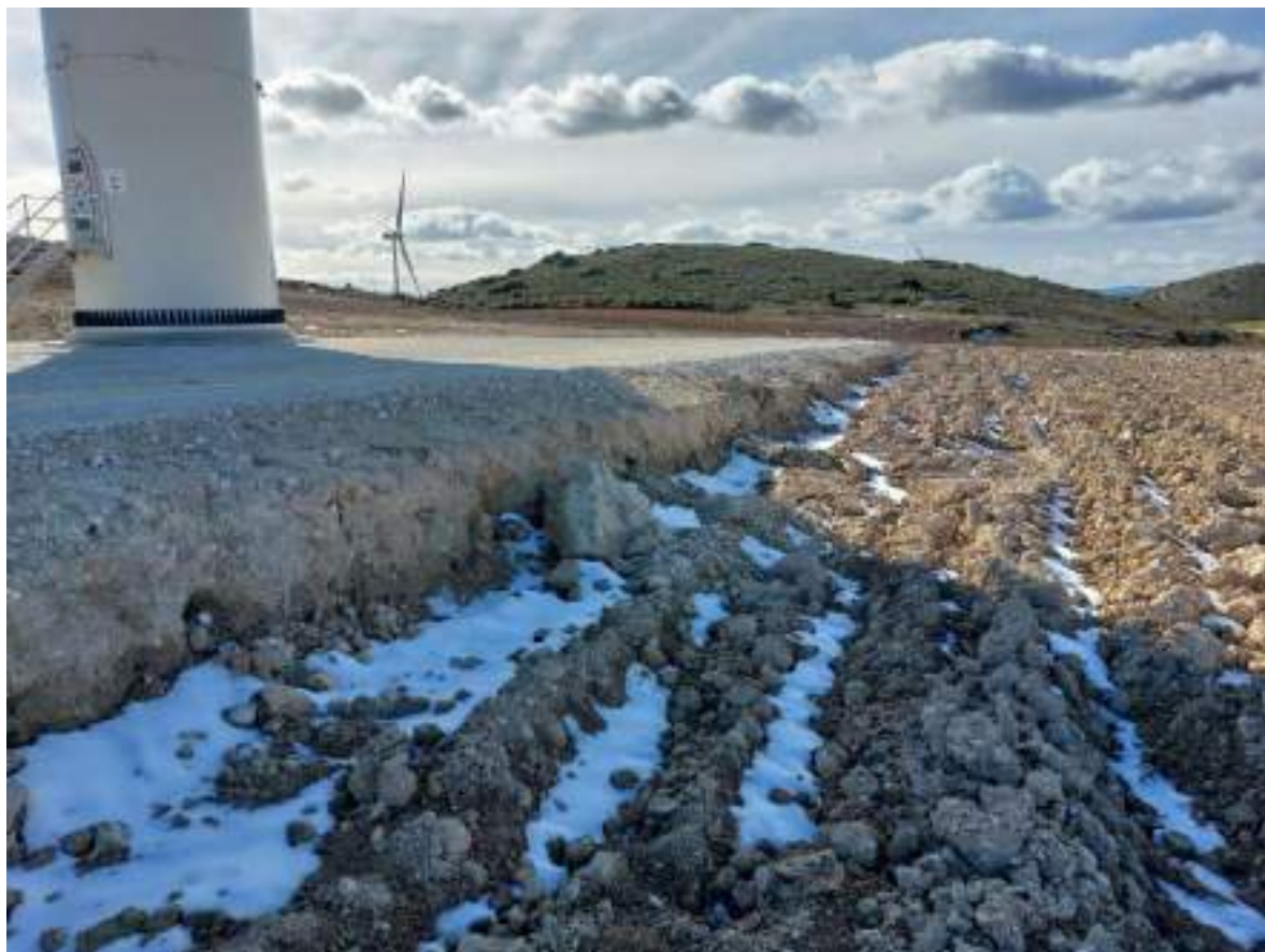
Imagen 3. Posición SBI-04 tras finalizar la restauración. Se debe reducir el salto que hay entre plataforma y campo de cultivo creando una pendiente gradual.
