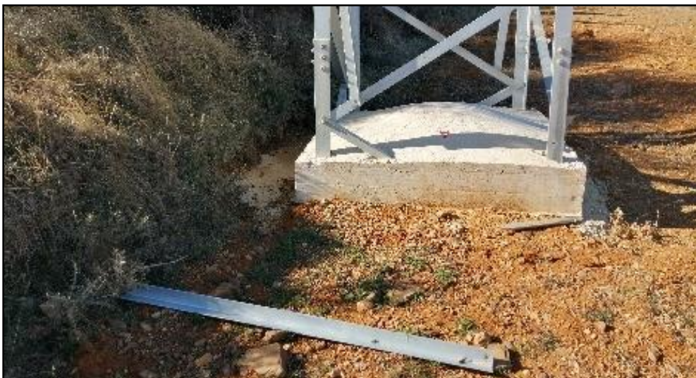
Fotografía 2. Travesaño metálico desprendido bajo el apoyo eléctrico LPDH-07.
