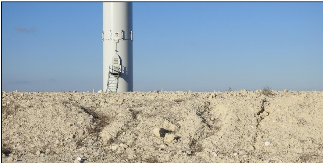
Fotografía 1. Pequeñas cárcavas en el talud del aerogenerador HE-01.
