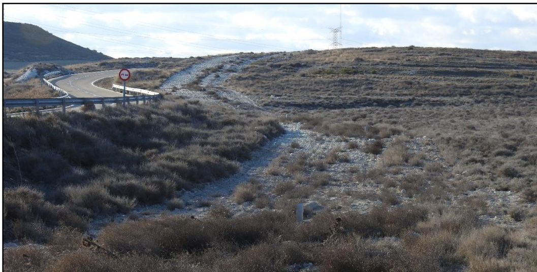
Fotografía 9. Zanja de media tensión provista de vegetación.
