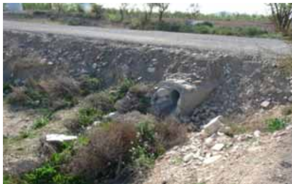
Foto 6. Drenaje vial con capitanas acumuladas
