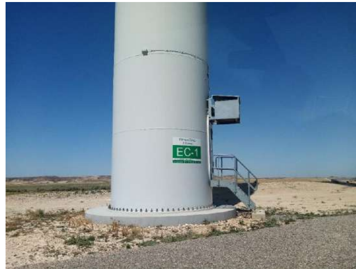
Fotografías 7 a 9: Señalización de las torres de los aerogeneradores
