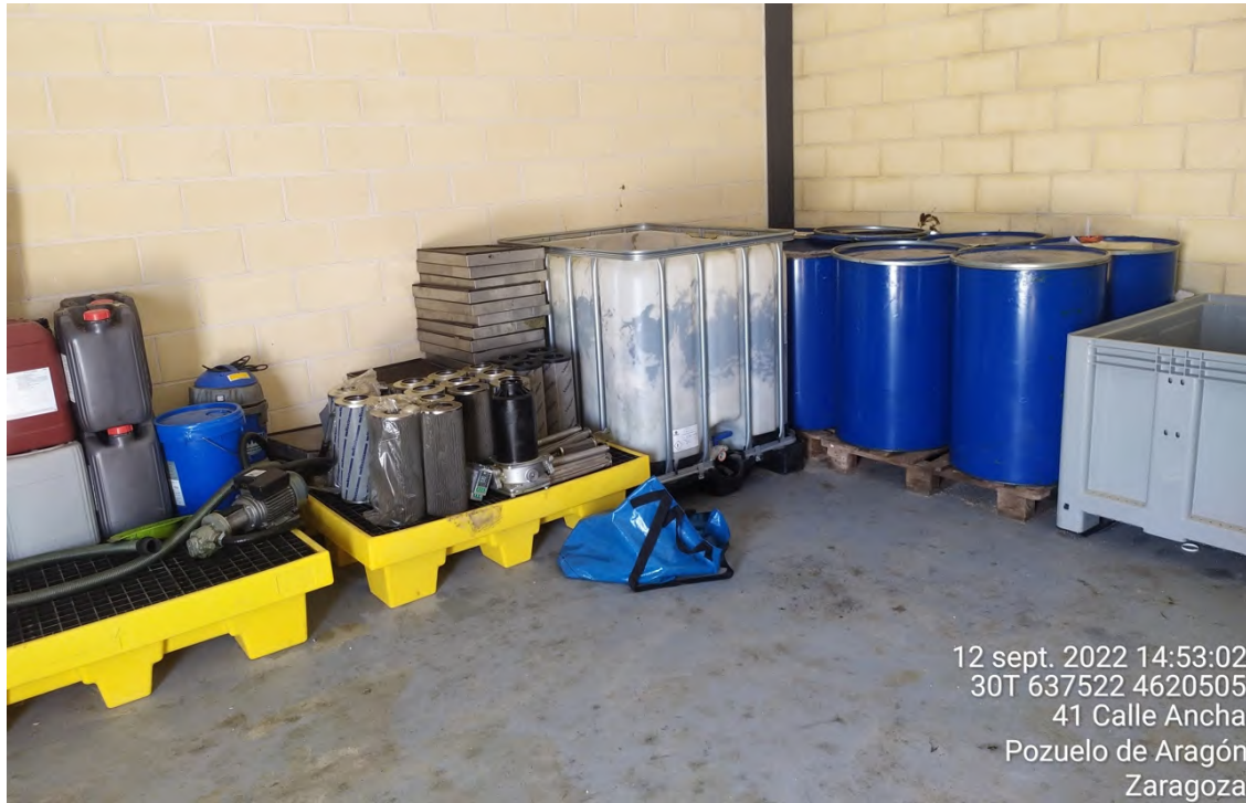
Figura 35: Interior del almacén de residuos peligrosos del PE El Llano a septiembre de 2022.
