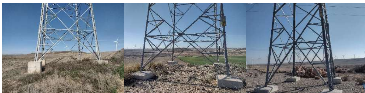
Foto nº18.: Estado general de los apoyos. Ejemplo del Apoyo nº 17, Apoyo nº 18 y Apoyo nº 23 de la LAAT.
