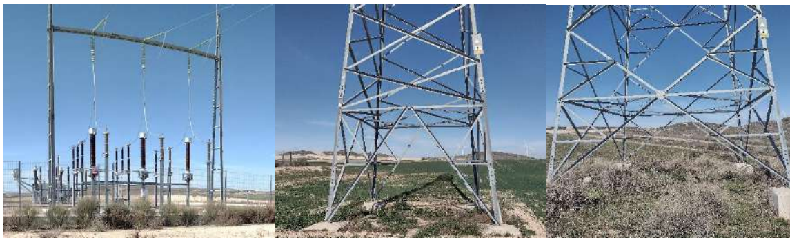
Foto nº15.: Estado general de los apoyos. Ejemplo del Apoyo nº 1 y nº 2 de la LAAT.
