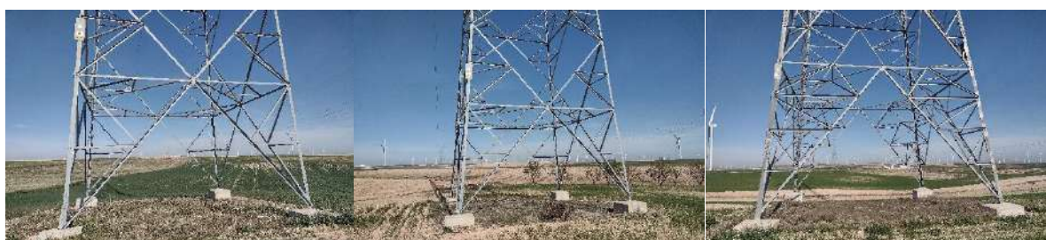
Foto nº16.: Estado general de los apoyos. Ejemplo del Apoyo nº 8, Apoyo nº 9 y Apoyo nº 11 de la LAAT.
