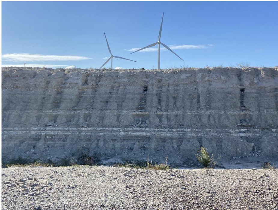
Figura 10: Fotografía de la erosión del talud al sur de la plataforma del aerogenerador CDM-02. Pueden observarse varias cárcavas provocadas por el agua de precipitaciones torrenciales.
