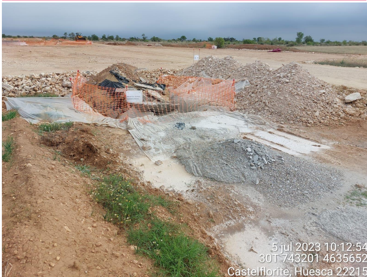
Imagen 1. No conformidad leve. Suelo contaminado por residuo de hormigón en SCII-01 debido al mal lavado de las cubas.
