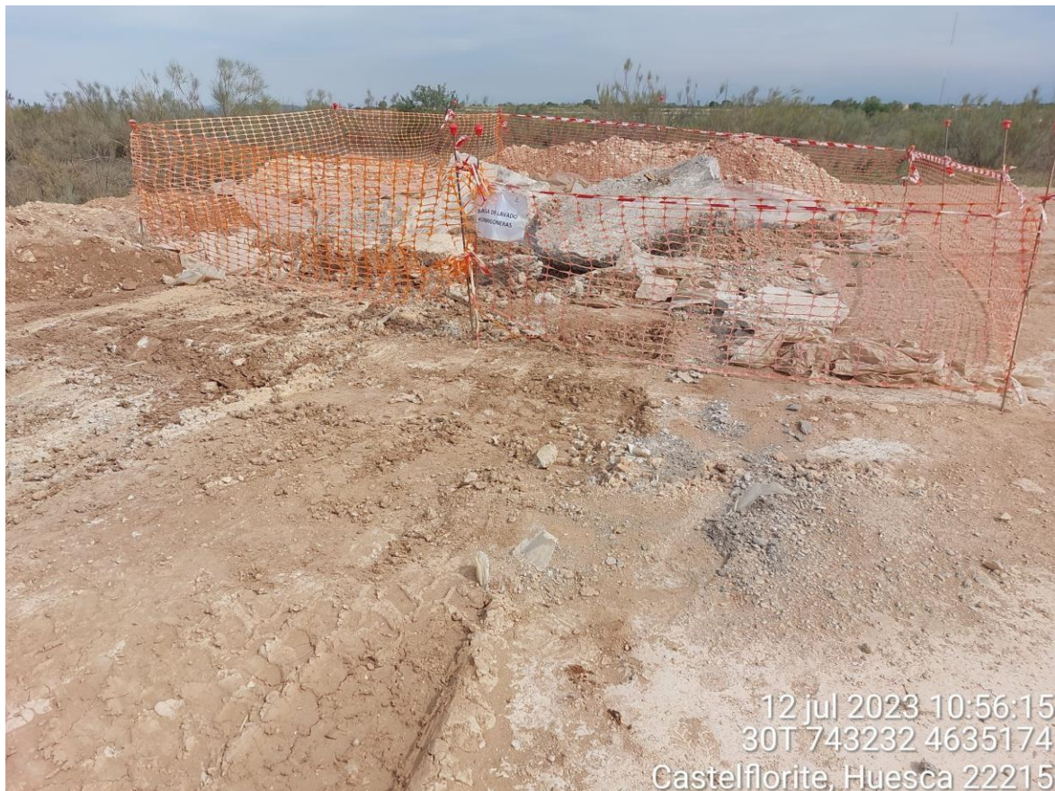
Imagen 3. Restos de hormigón en el pozo de lavado en SC2-02.
