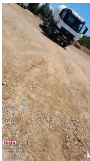
Restos de hormigón de cubas en posición SE2-11.
