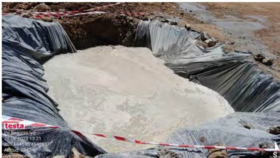
Pozo de lavado en mal estado en SE2-11.
