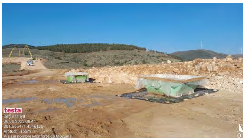
Contenedores para limpieza de hormigón.
