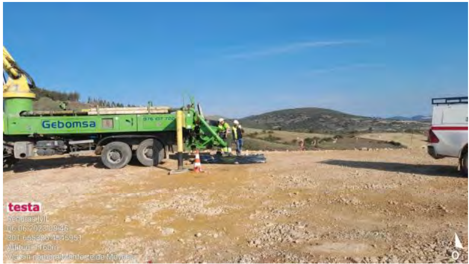
Aislamiento para derrames en bomba.
