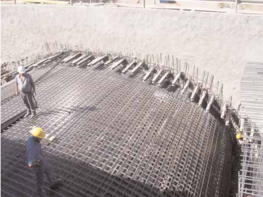
Obras de consolidación del antiguo acueducto del Canal Imperial de Aragón (Zaragoza)
